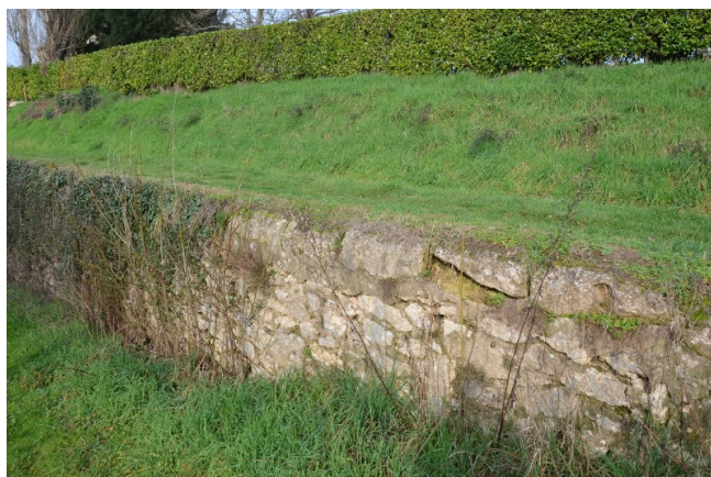
Détail du mur de soutènement du chemin de halage au-dessus de la cale d'accès au bac
