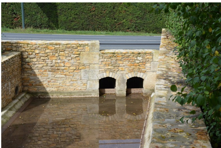
Les vannes d'écoulement
