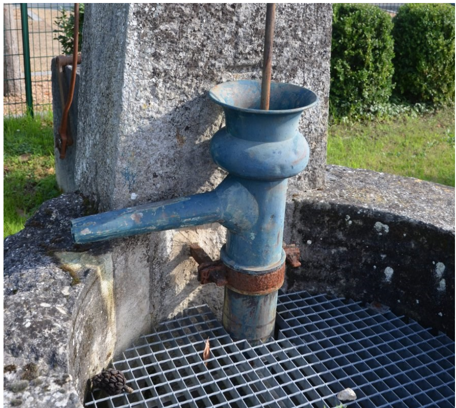
La grille de sécurité et la partie visible de la pompe
