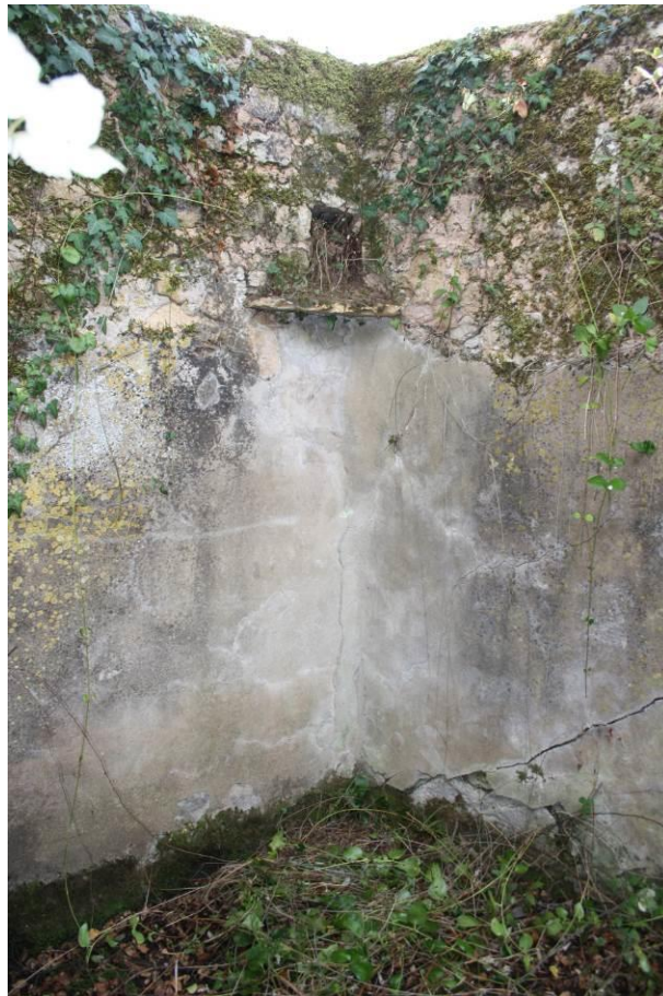
Angle nord-ouest avec dispositif d'alimentation
