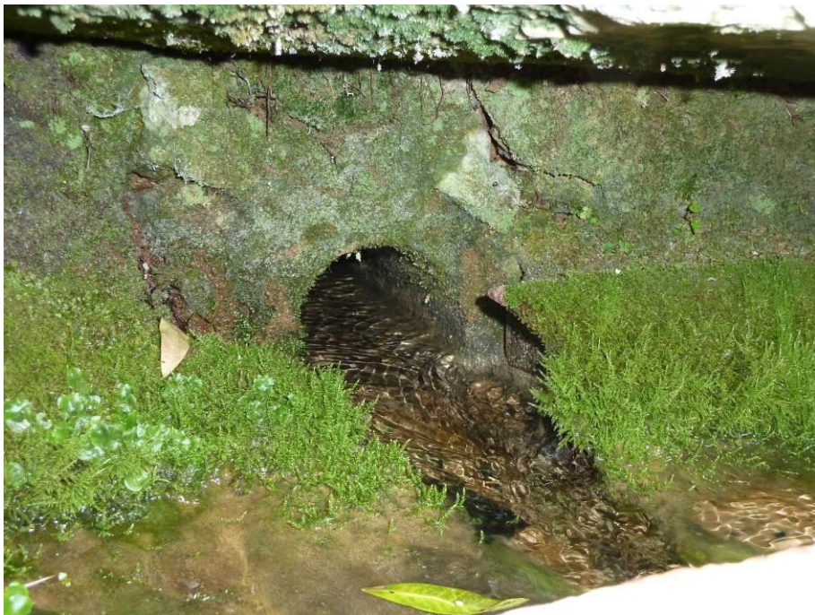
Intérieur du bac répartiteur et arrivée d'eau
