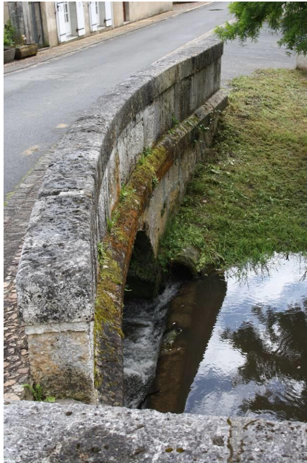
Seuil déversoir avec vanne
