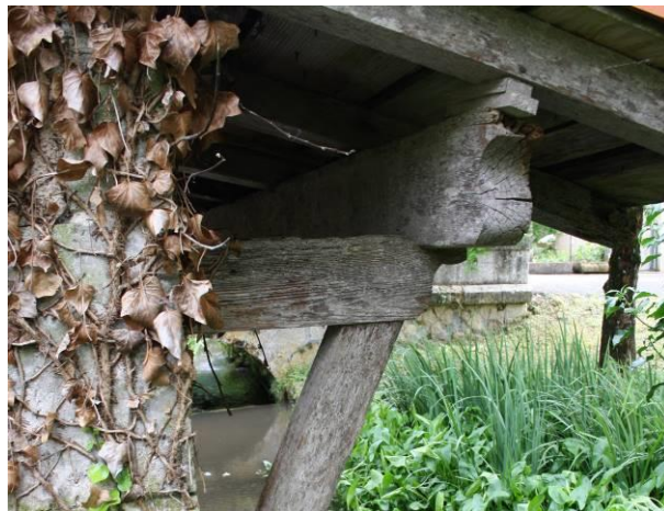
Extrémité nord de la panne sablière vermoulu
