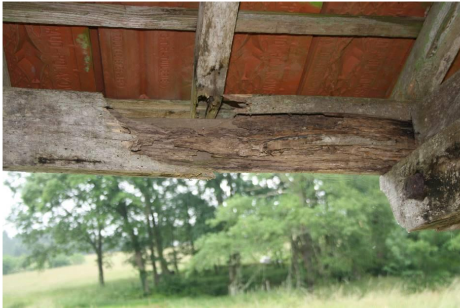
Panne sablière de l'angle sud est
