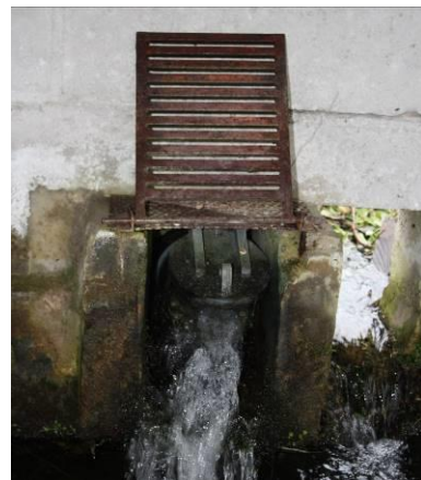
Clapet anti retour sur l'arrivée d'eau ouvert
