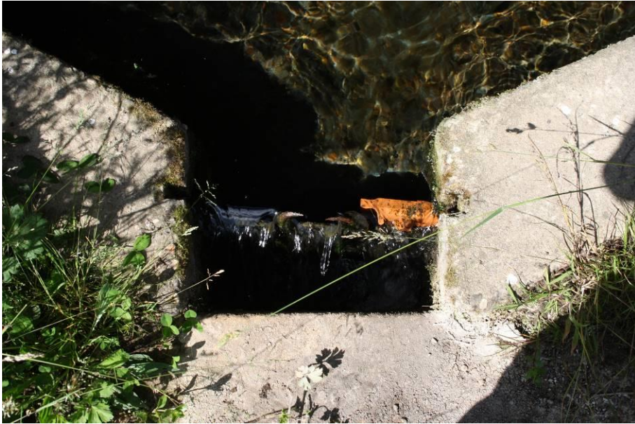
Vanne de vidange et de réglage du niveau de l'eau
