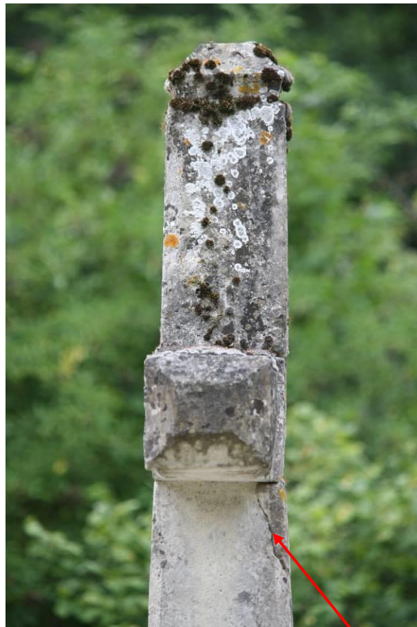
Fissure au sommet de la hampe
