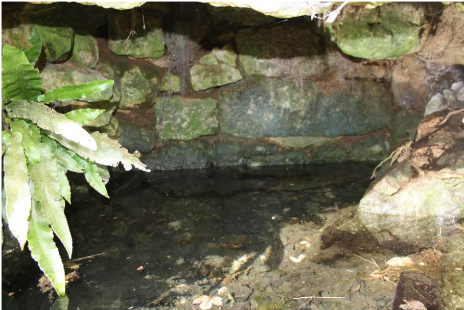
Source couverte d'une dalle. On voit les racines du frêne en haut à gauche
