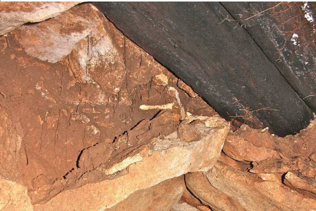
Eboulement réparé par des traverses ferro- viaires
