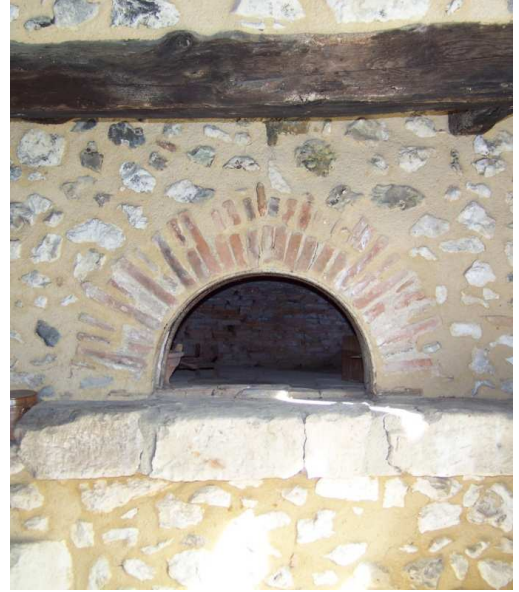
L'entrée du four
