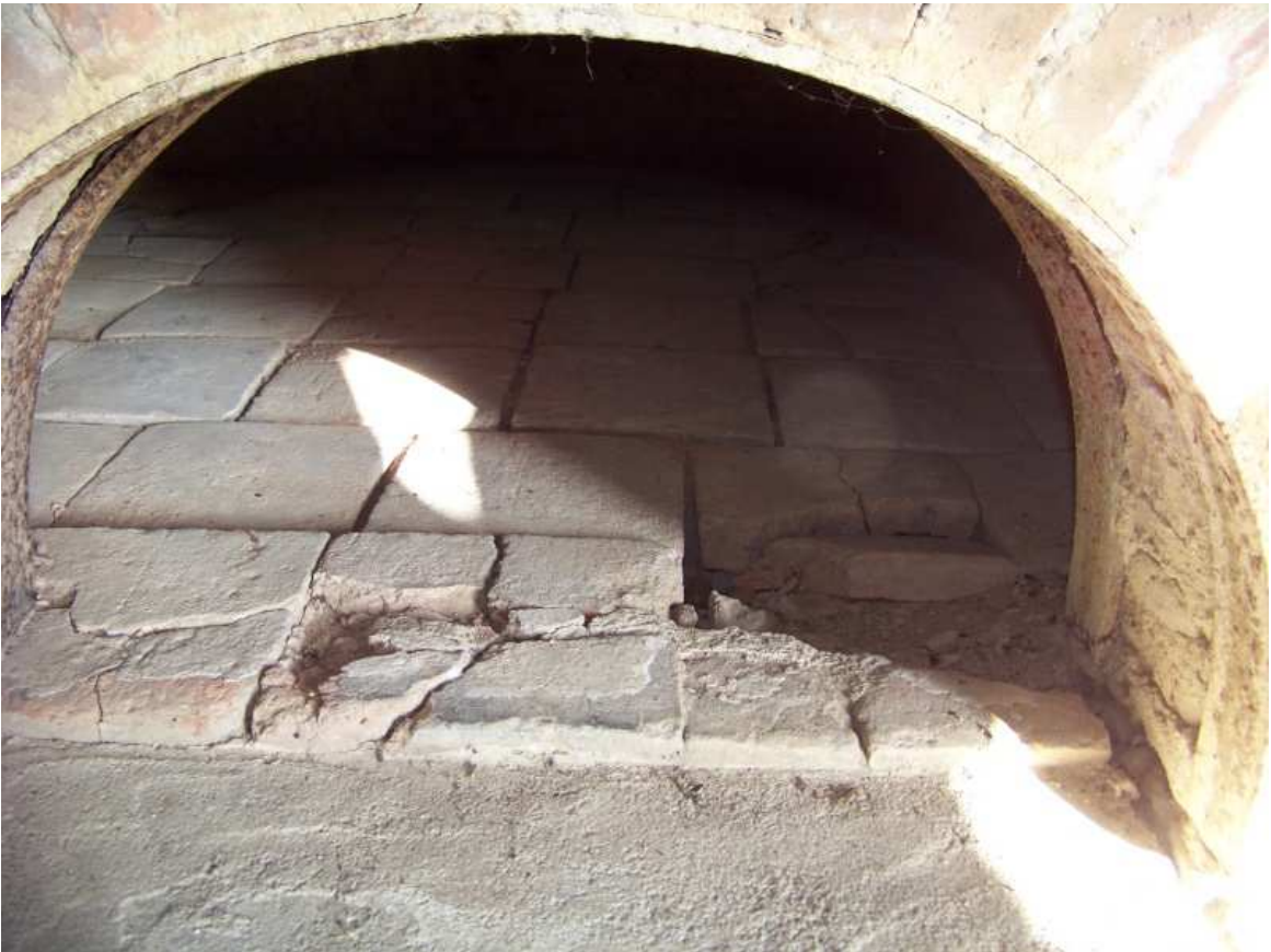
L'entrée du four
