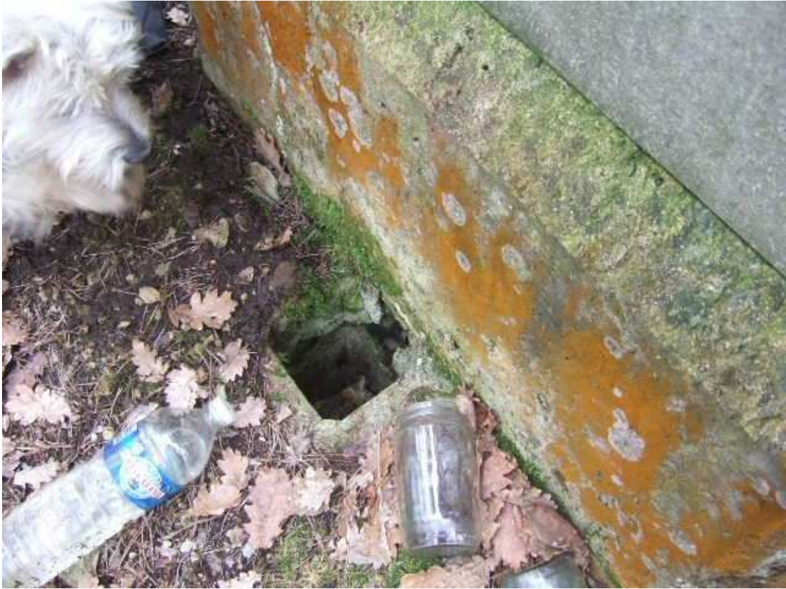
Trou à l'arrière de l'édifice
