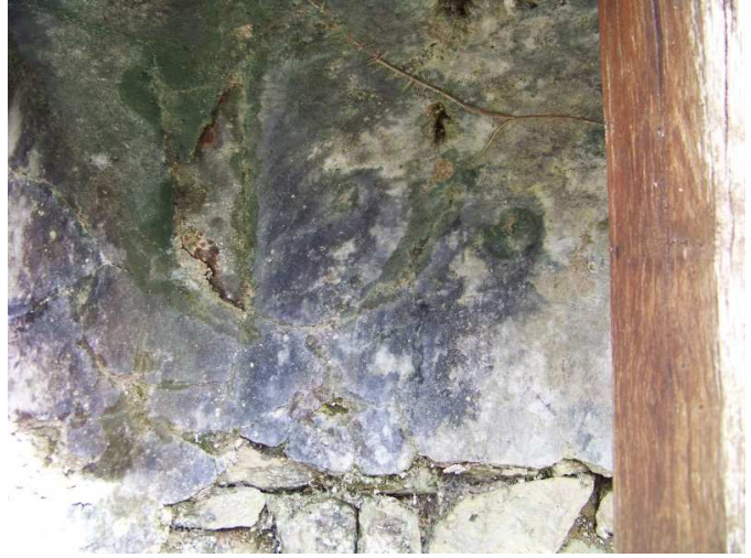
Enduit restant sur le haut du mur de la niche de la croix centrale
