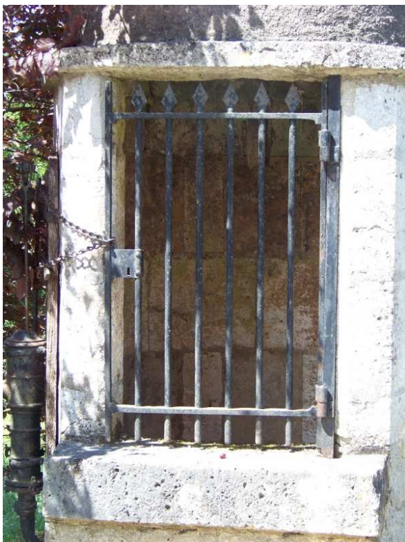
La grille d'entrée
