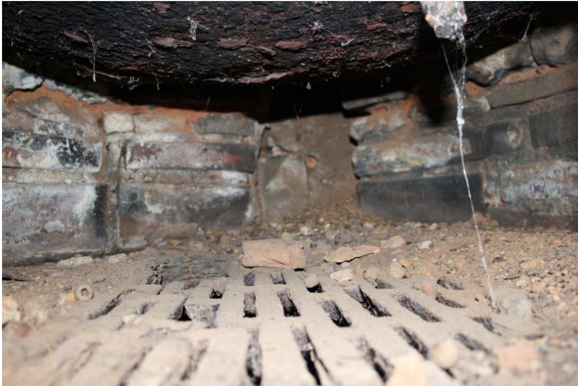
Intérieur du fourneau et fond de la chaudière
