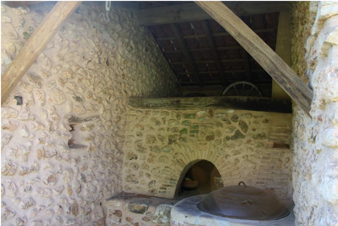
Façade du four
