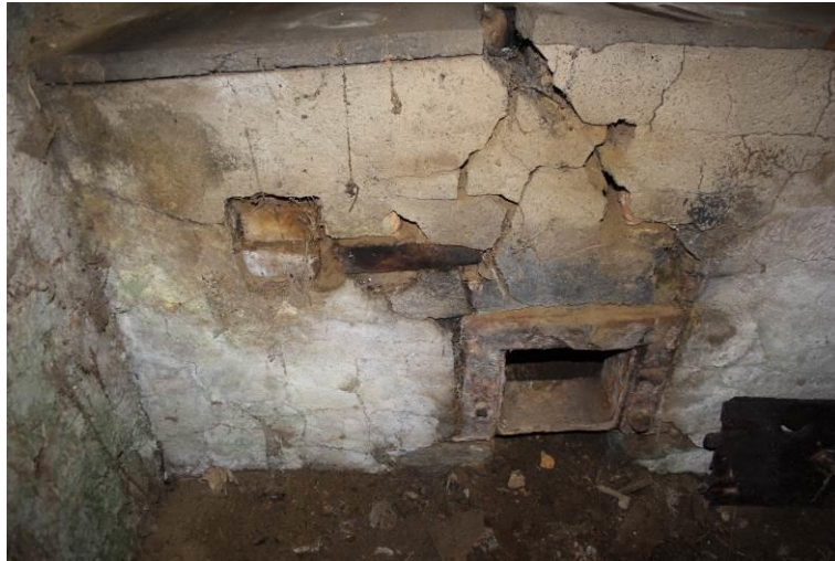
Chaudière vue de face
