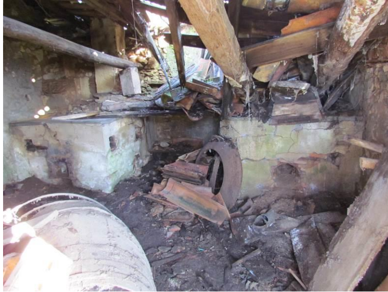
Les deux chaudières vues de l'entrée du bâtiment
