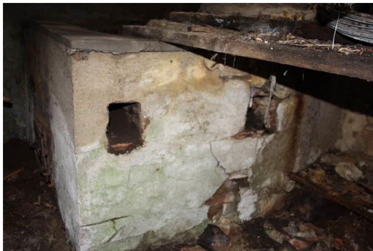
Chaudière vue de droite
