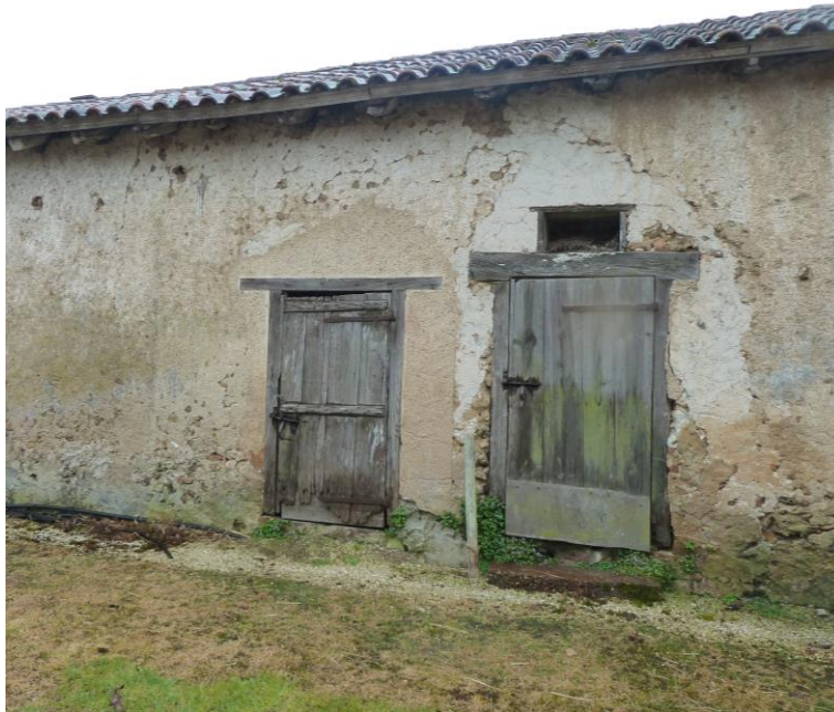
A gauche, porte d'entrée du niveau bas du clédier A droite, porte d'entrée de la salle de gavage donnant accès au niveau haut du clédier
