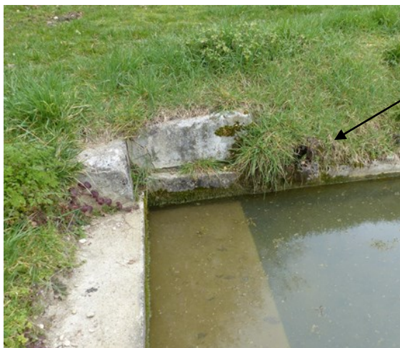
Arrivée d'eau en provenance du bassin
