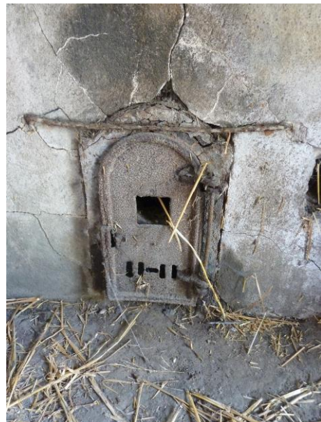
Foyer du fourneau de droite
