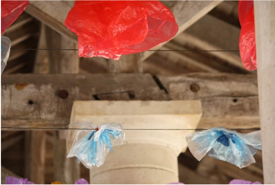
Ferme D vue du nord avec rupture de l'assemblage
