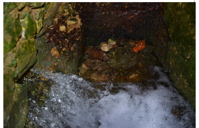
Sortie de l'eau après fortes pluies
